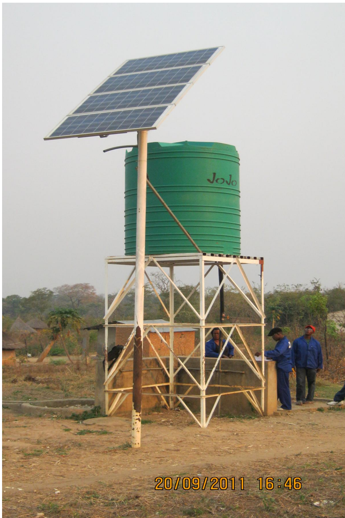
Bomba de Agua alimentada com painel solar- Manica
