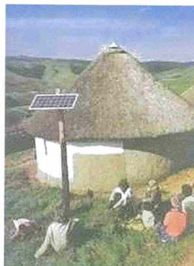
Foto 13 Sistema solar de casa individual de 50 Wp
