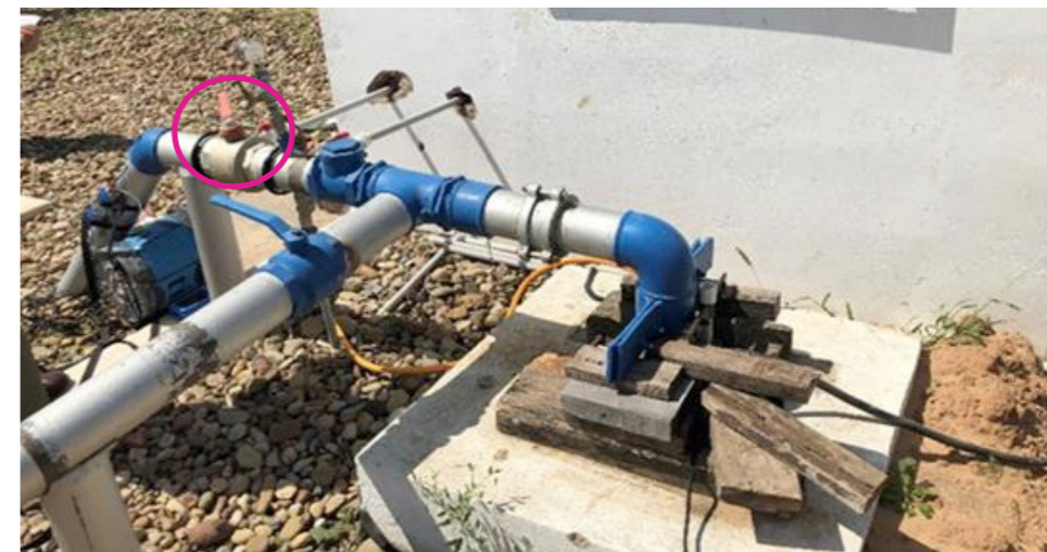
Figura 2.6 Llave parcialmente cerrada salida del pozo
