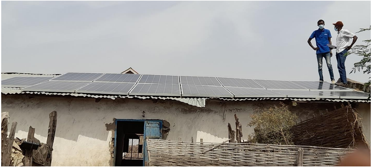
Figure 3 : Le champ solaire photovoltaïque installé sur le toit
