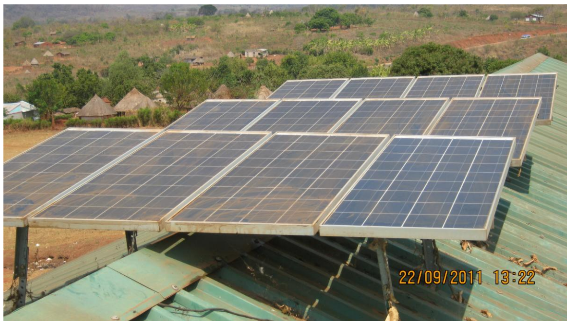
Paineis solares instalados em Manica
