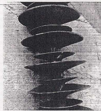
FIGURA 17B: Estado dos Insuladores no Beira 1 Status of Beira 1 insulators
