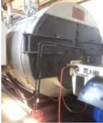
Réglage des chaudières
