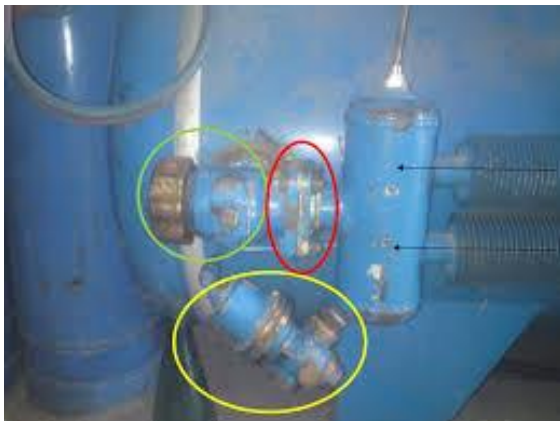
Fuites air comprimé
