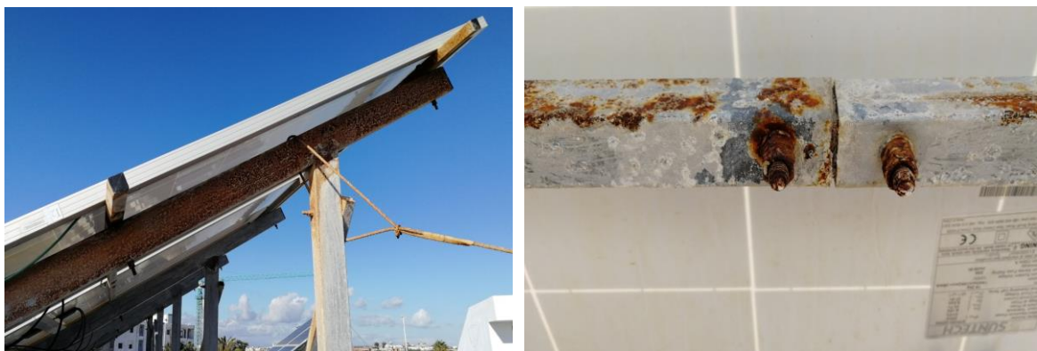
Figure 16: Installation PV en face de mer, sa structure en aluminium est corrodée
