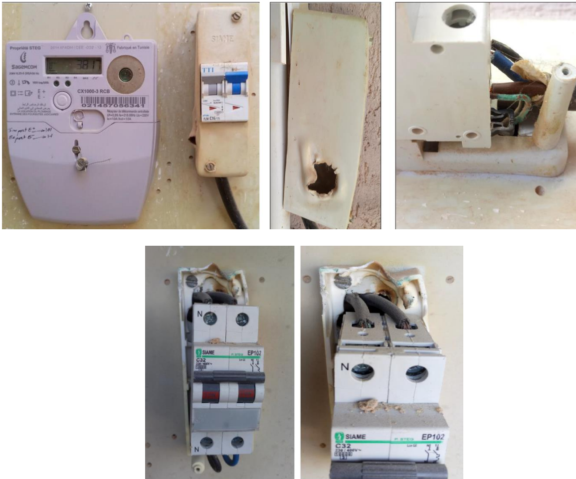
Figure 50 : points chauds et fusion au niveau du raccordement réseau
