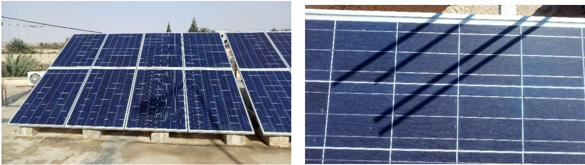
Figure 33: problème d'ombrage - autres accessoires
