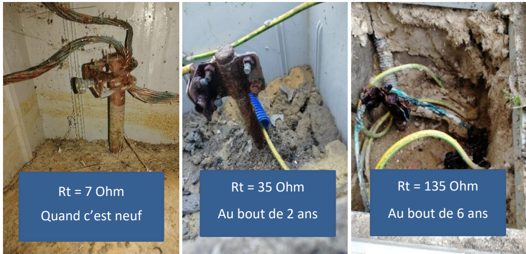
Figure 54: exemples de piquet de terre
