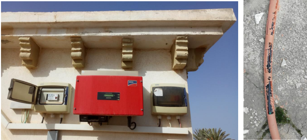
Figure 40: emplacement à éviter (onduleur, coffrets et gaines en plein soleil)
