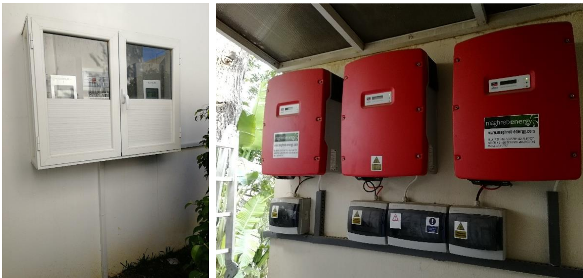
Figure 39: un environnement bien conçu pour les onduleurs
