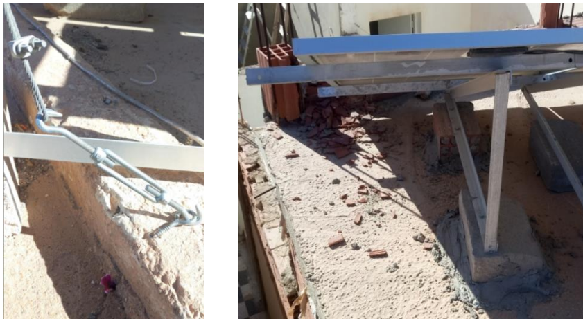
Figure 15: haubanage mal fixé (à gauche), porte à faux trop important (à droite)
