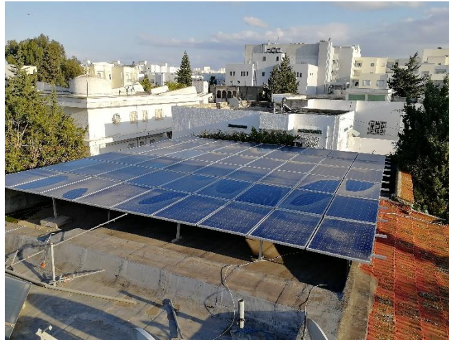
Figure 35: stagnation de l'eau sur les modules
