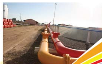
Vista parcial da instalação oceânica da Berra
